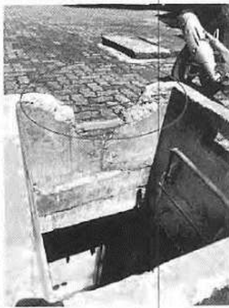
Foto 112: Vista da cisterna. Necessário reparos na alvenaria externa.
