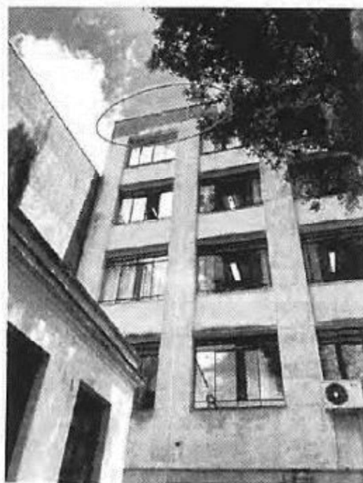
Foto 58: Vista externa do bloco, com destaque para desprendimento do revestimento.
