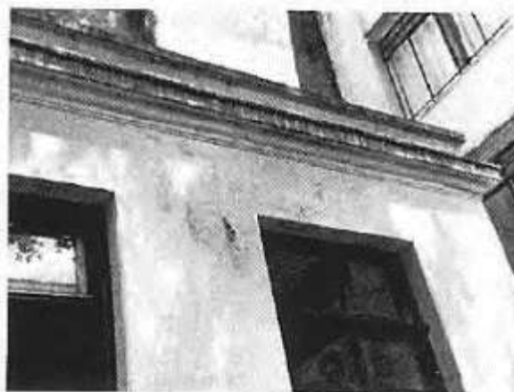
Foto 52: É necessário reparos na pintura.
