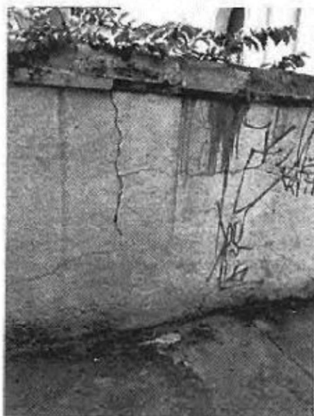
Foto 105: Muro externo (Rua Lubavitch). Necessário reparos.
