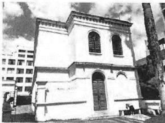
Foto 33: Fachada principal de acesso ao bloco. Falta de acessibilidade.
