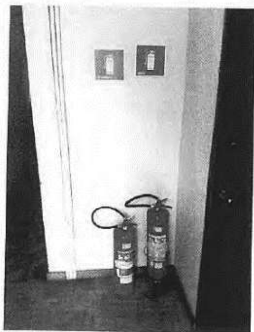
Foto 35: Extintores de incêndio, dentro do prazo de validade. Porém, ambos devem obedecer a IT nº 21/2011.
