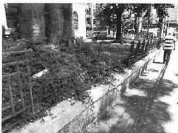
Foto 107: Gradil da Rua Três Rios necessita reparos.
